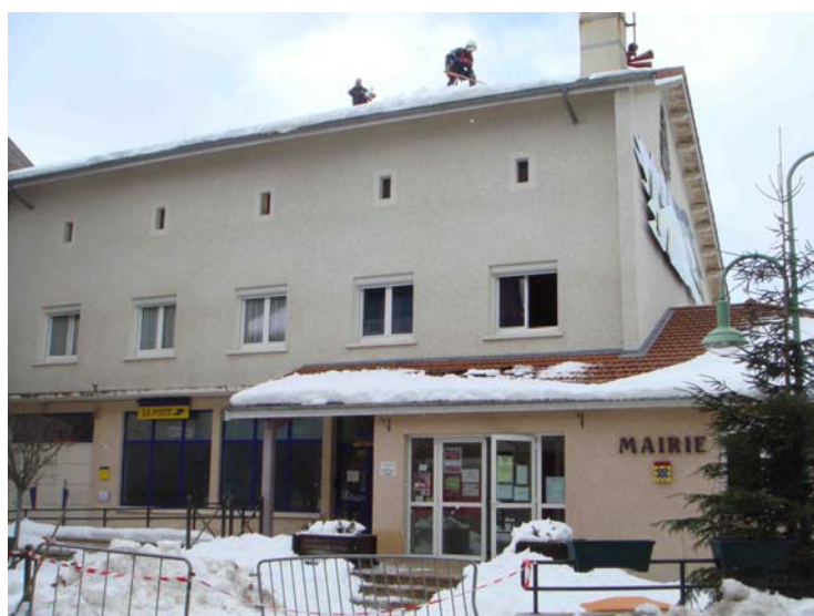
Dégâts occasionnés lors du dégel par la chute de plaques de neige
